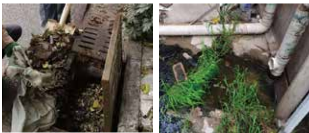
图1 雨水口堵塞及住户私接污水管
