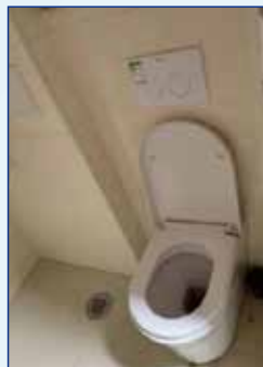
图2 后排水坐便器及隐蔽式水箱装饰墙
