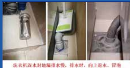
图6 洗衣机深水封地漏返水
