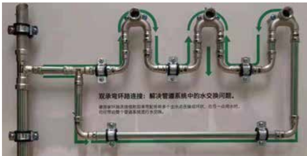
图9 应用双承弯管件组成环状供水管路连接实物图
