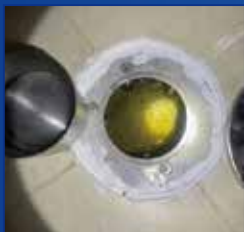
图4 淋浴地漏返污水
