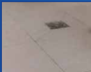
图5 淋浴地漏下水慢
