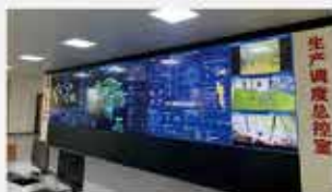
福鼎市城乡供水一体化工程数字化应用研究 (荣获福建水利科学技术二等奖)
