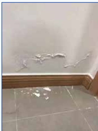
图7 墙体漏水脱皮
