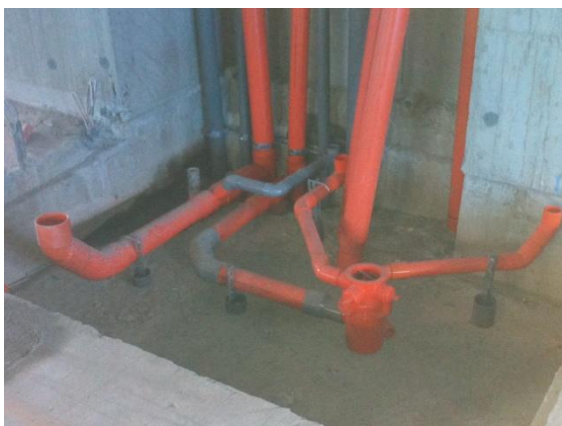
圖 26 臺灣臺北市敦年建設〈凱旋大道〉，運用總存水彎完成浴室雙層樓板配管，阻絕排水噪音；並選用高吸量吸氣閥(17.7L/s)位於當樓層天花板內提供排水進氣。
