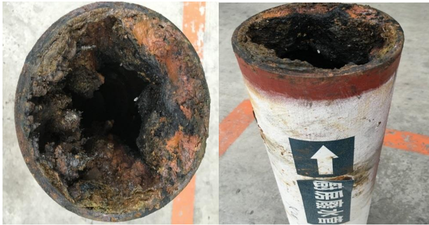
圖 2 廚房排水共用管路油脂阻塞情形
