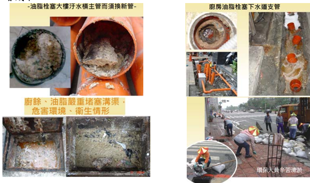
圖五 污水管線因油脂皂化形成之堵塞現象、水溝被廚餘阻塞以及環保人員辛苦清淤之實際情形
