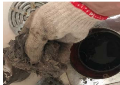
圖 9 淋浴間落水口與存水彎的清除物（毛髮、泥垢）
